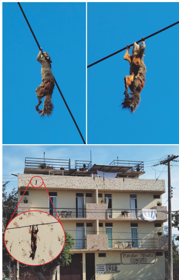
Ardilla gris ( Sciurus aureogaster ) electrocutada en cables de alta tensión. Fotografía: Jesús García Grajales
